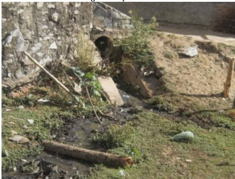
Foto 15: Rede de Esgoto Lançando Efluentes no Rio Una.
