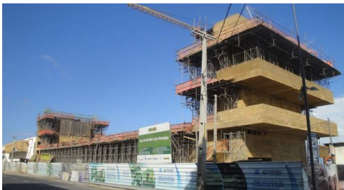
Figura 18: Cais do Sertão – Museu de Luiz Gonzaga (Em reforma). FONTE: BARBOSA, David Tavares. Trabalho de Campo, janeiro de 2014.
