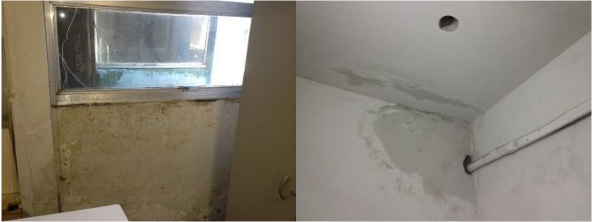
Figura 10 – Infiltrações em paredes internas e ausência de fechamento em alvenaria devido à passagem de tubulação (Edf. Gil Maranhão – Auditório Benício Dias)
