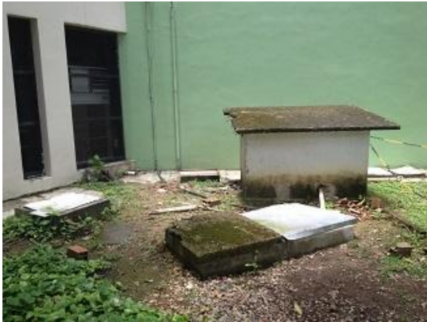
Figura 16 – Laje e tampa de concreto armado com ferragem aparente (Edif. Dirceu Pessoa)
