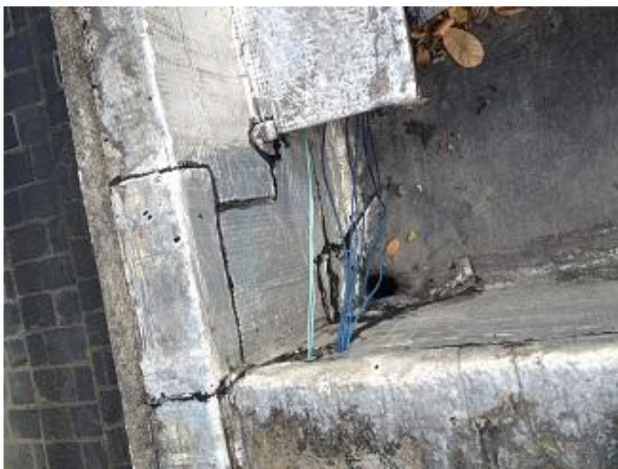
Figura 5 – Fiação aparente na cobertura (Edif. Gil Maranhão - Museu)
