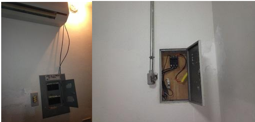
Figura 9 – Instalações elétricas inadequadas, quadro elétrico fora de norma, base de madeira (Edif. Gil Maranhão)
