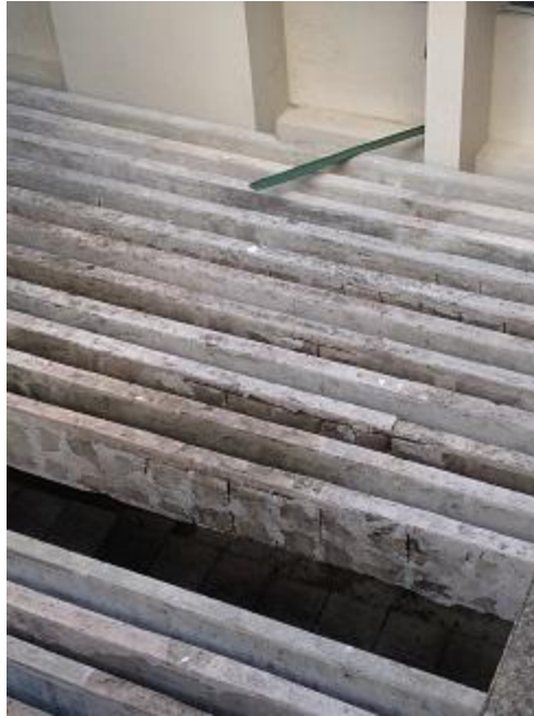
Figura 8 – Ferragem aparente em concreto armado (Edif. Dirceu Pessoa)
