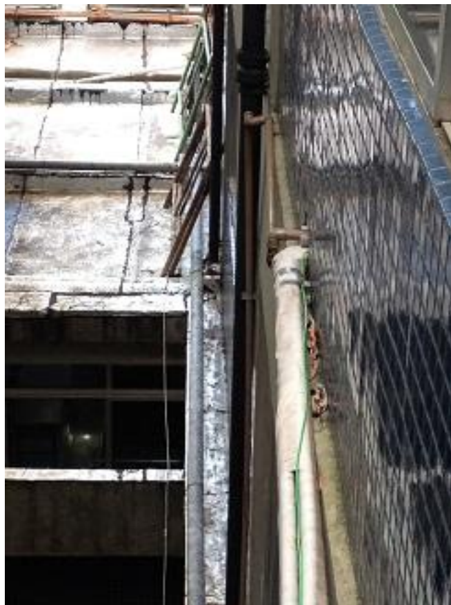
Figura 11 – Tubulação de ar-condicionado e de drenagem fachada (Edf. Paulo Guerra)
