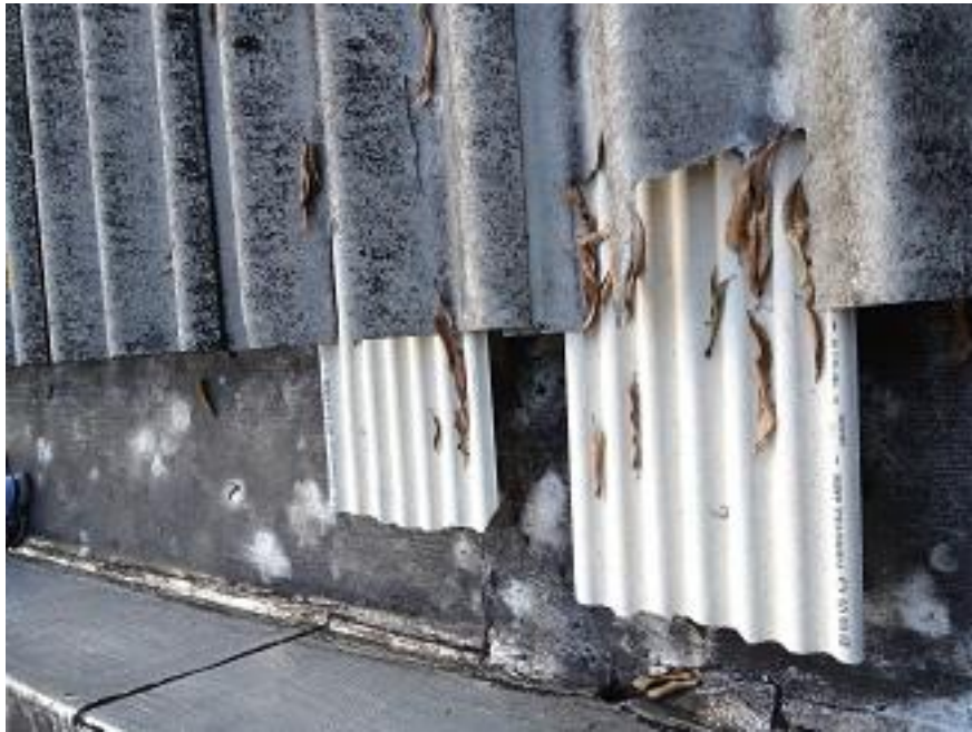
Figura 6 – Telhas quebradas na cobertura (Edif. Gil Maranhão - Museu)
