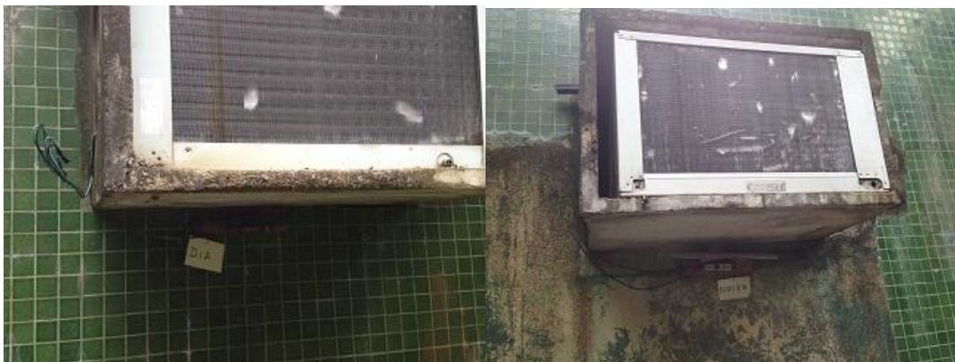
Figura 14 – Disjuntores localizados ao “ar-livre”, com fiação aparente e base de madeira (Edf. Dirceu Pessoa)
