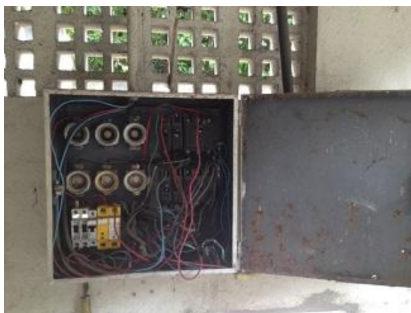
Figura 15 – Quadro elétrico fora de norma, fiação inadequada (Edf. Antiógenes Chaves)
