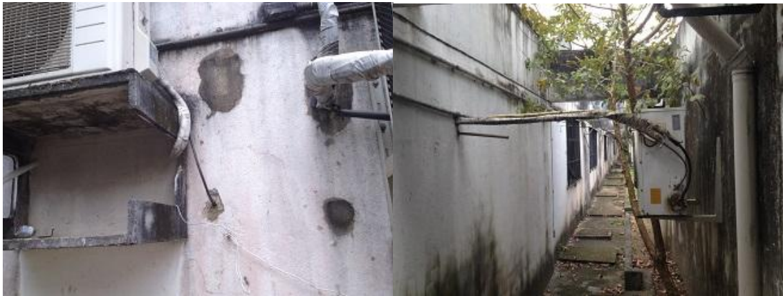
Figura 13 – Instalações de ar-condicionados inadequadas tubulação/drenagem (Edif. Antiógenes Chaves)
