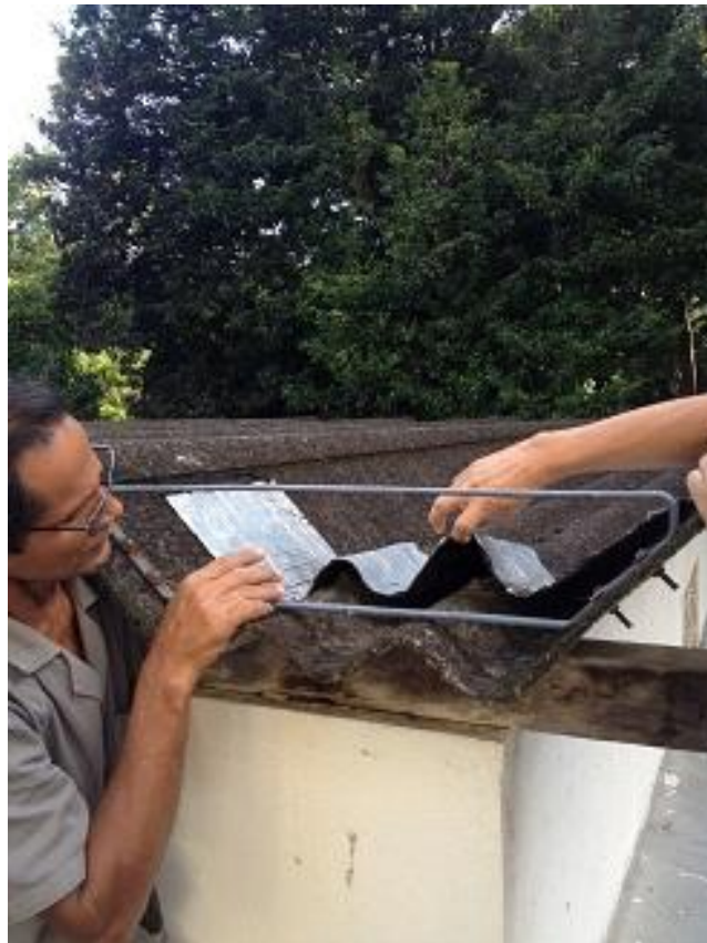
Figura 7 – Impermeabilização vencida (Edif. Renato Carneiro Campos)
