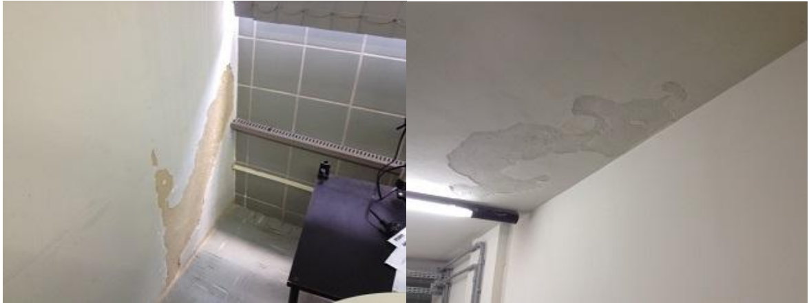
Figura 12 – Infiltração Paredes/Tetos Internos (Edif. Antiógenes Chaves)
