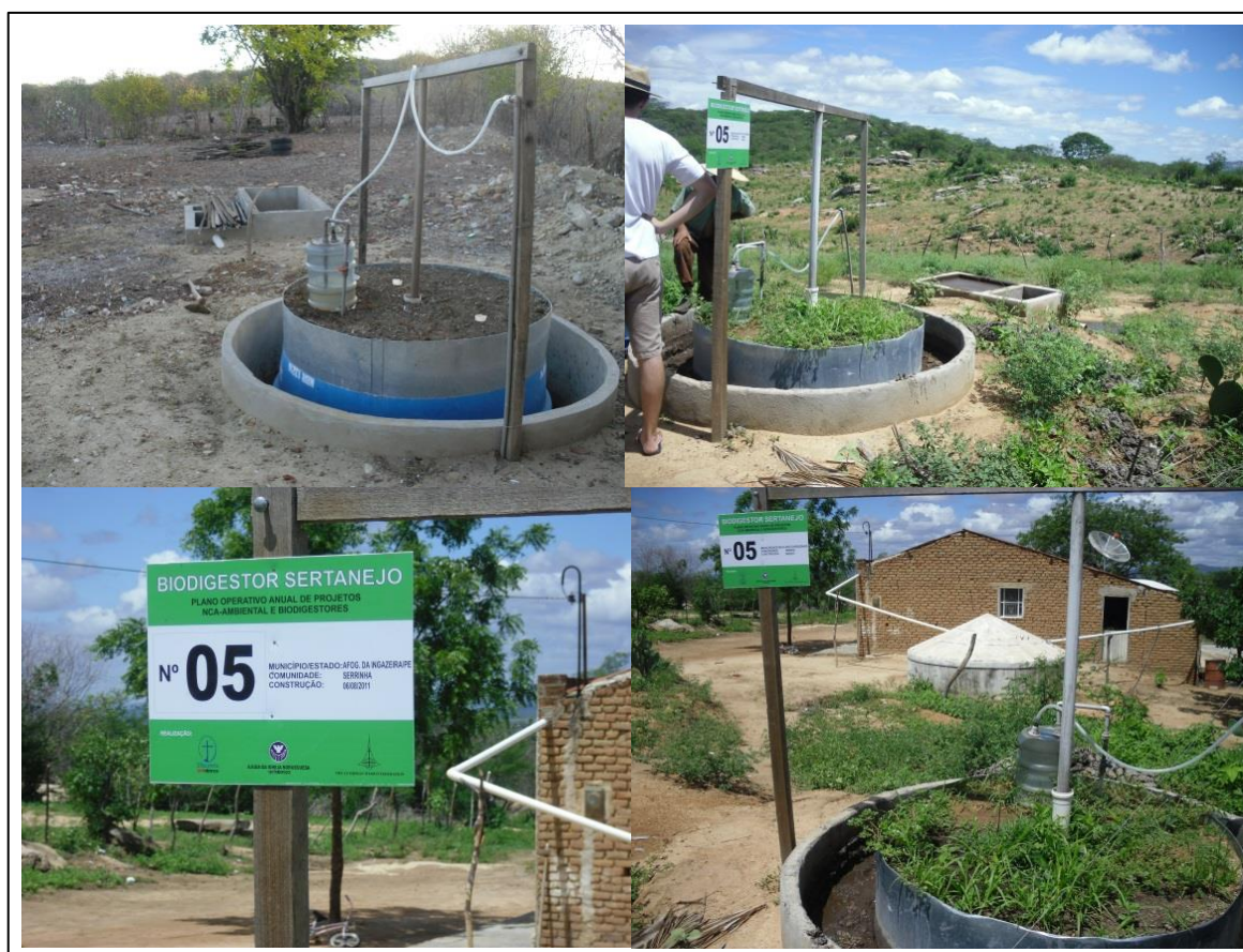
Figura 39 – Biodigestores em Afogados da Ingazeira
