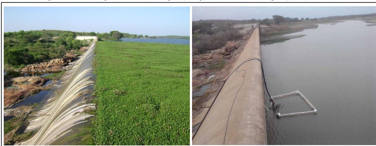
Figura 35 – Barragem Brotas em sangria (à esq.) em 2010 e em colapso (à dir.), em 2013.
