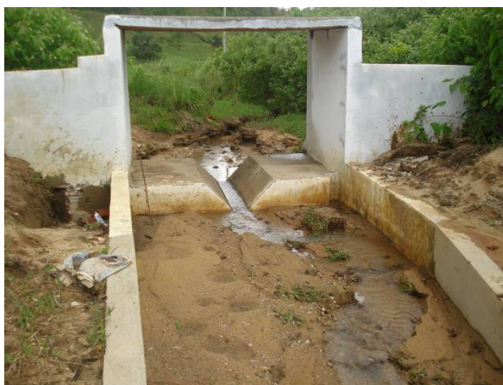
Figura 10. Fossa de sedimentação com acumulo de sedimentos, após um evento de precipitação médio.
