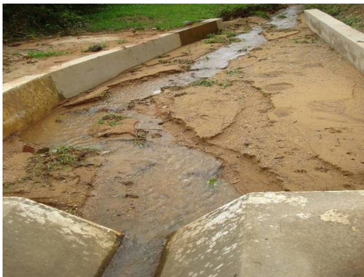
Figura 11. Fossa de sedimentação com grande acumulo de sedimentos.
