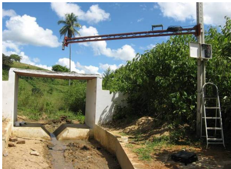
Figura 7. Instalação do sensor de Ultra-som.
