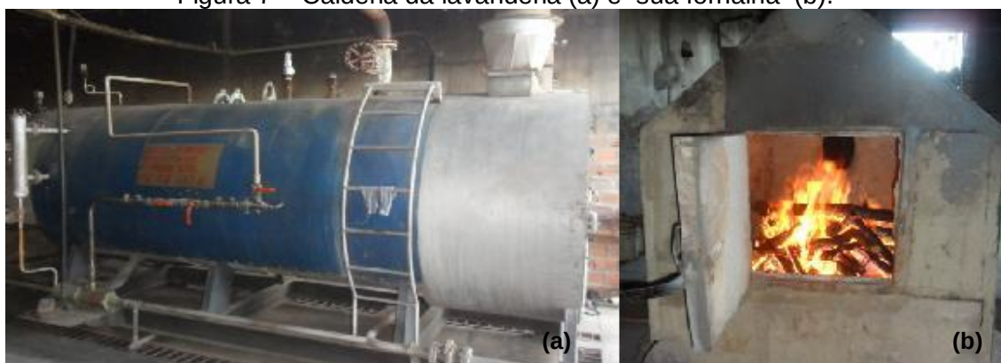
Figura 7 – Caldeira da lavanderia (a) e sua fornalha (b).
