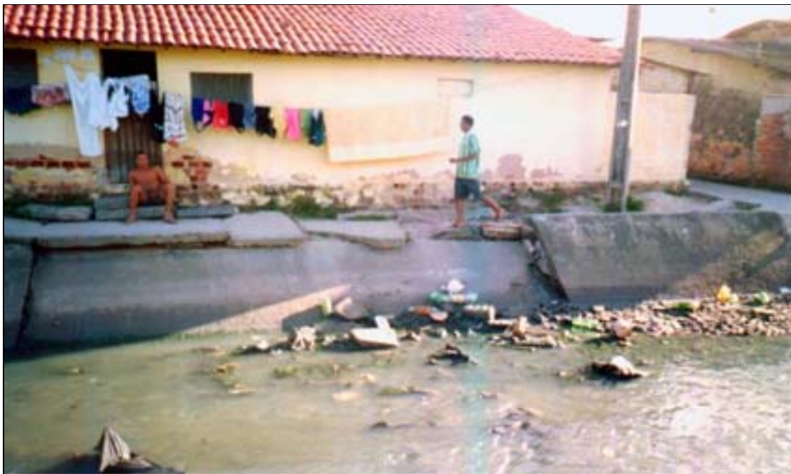
Foto 05 22 : Imagem de uma parte do canal que está caindo e da casa que está ameaçada.
