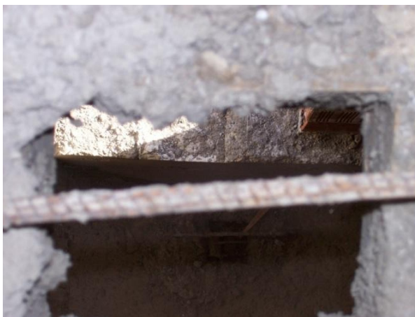
Figura 34 – Orifícios na laje e haste metálica.
