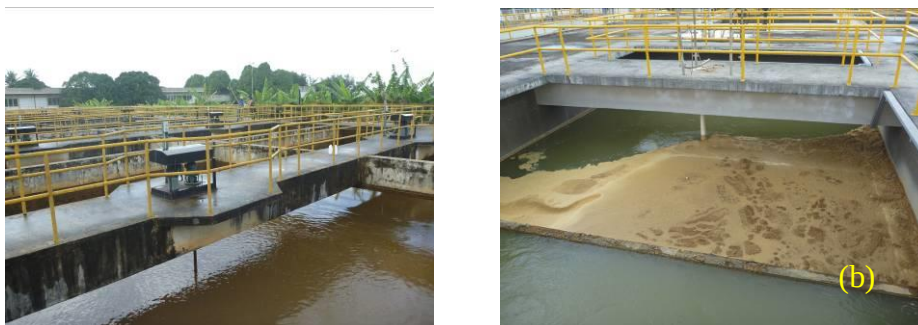
Figura 10 - Tanques de floculação da ETA-1(a) e ETA-2(b)
