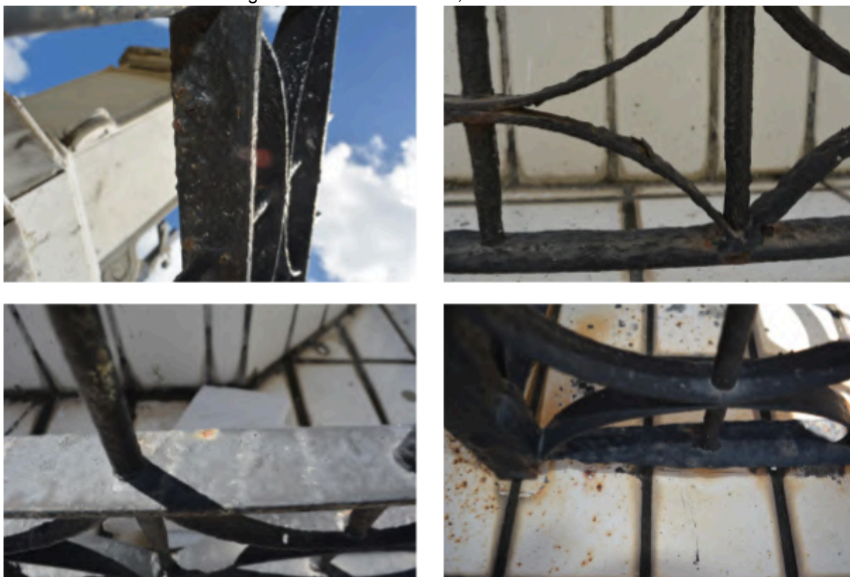
Figura 31 – Gradil R3N11S, danos em detalhe.
