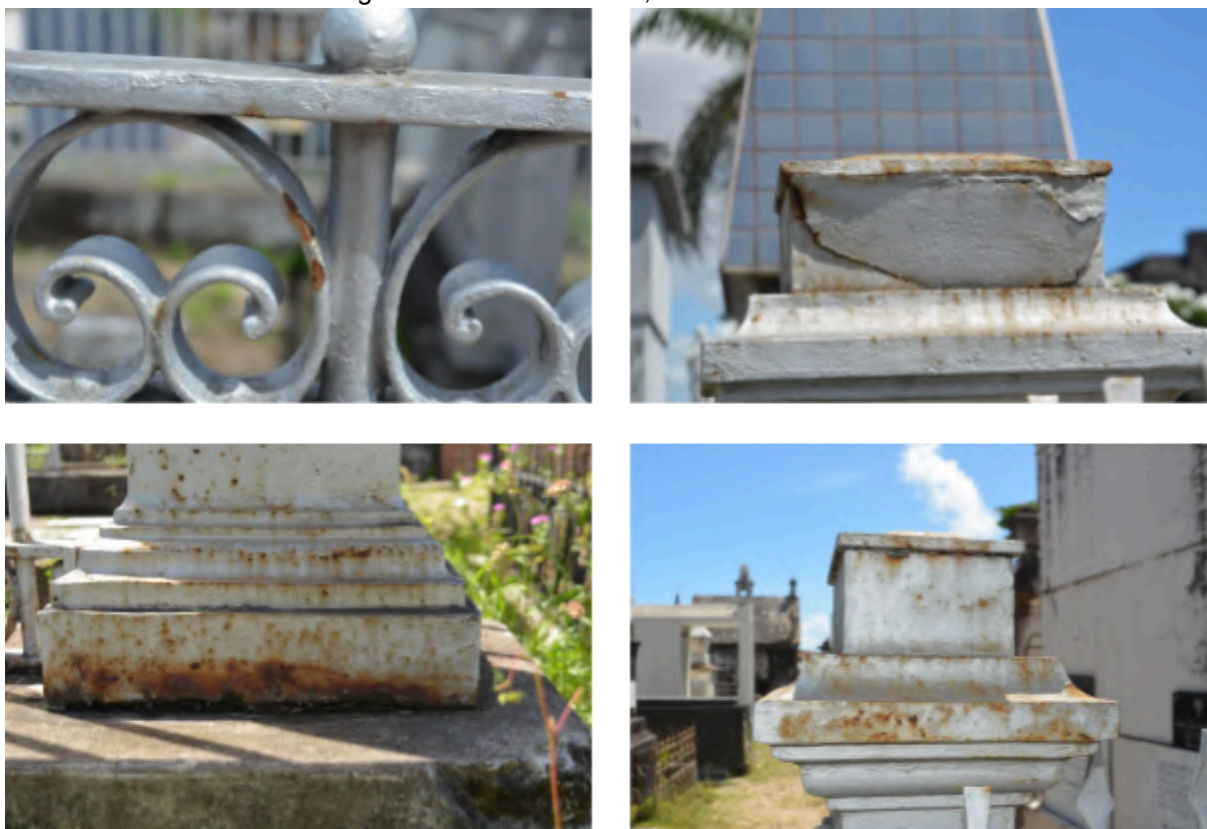
Figura 33 – Gradil R3N9N, danos em detalhe.
