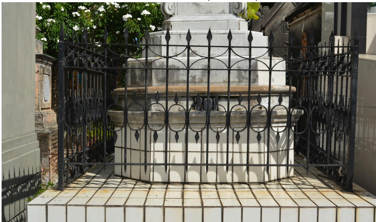
Figura 30 – Gradil R3N11S, em estado Ruim, com danos mais graves (Deformação e Quebra) e corrosões intermediárias, ainda que cobertas pela tinta.
