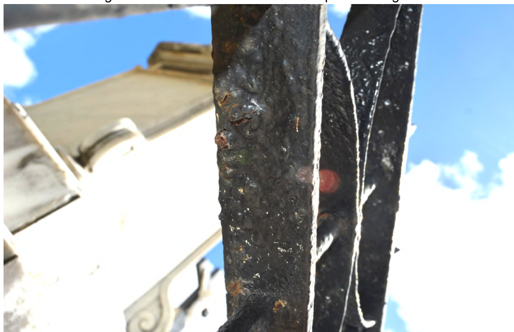
Figura 27 – Gominhos formados na superfície do gradil.
