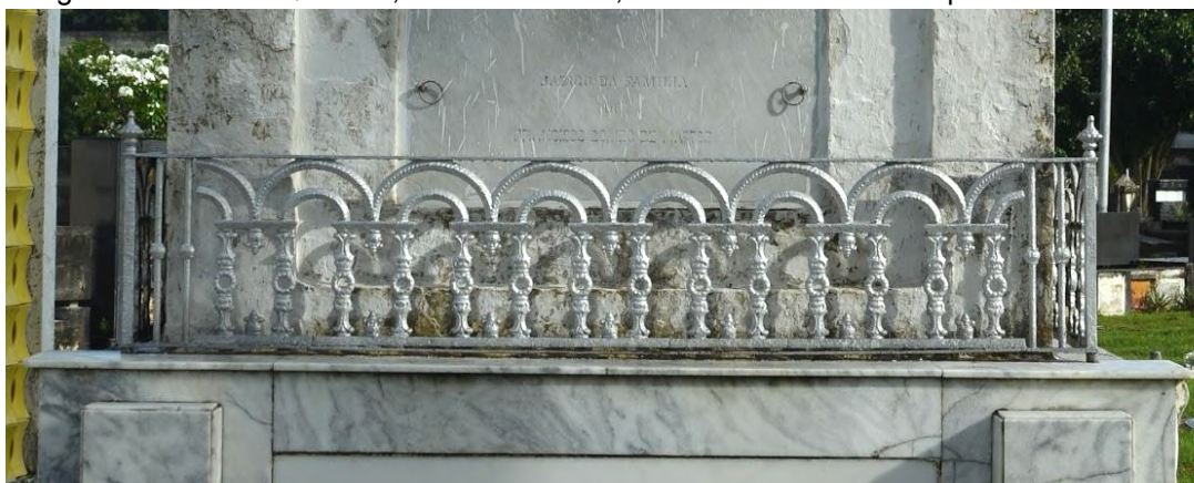
Figura 15 – Gradil Q26 F13, em estado Bom, com danos e corrosões pouco alastrados.
