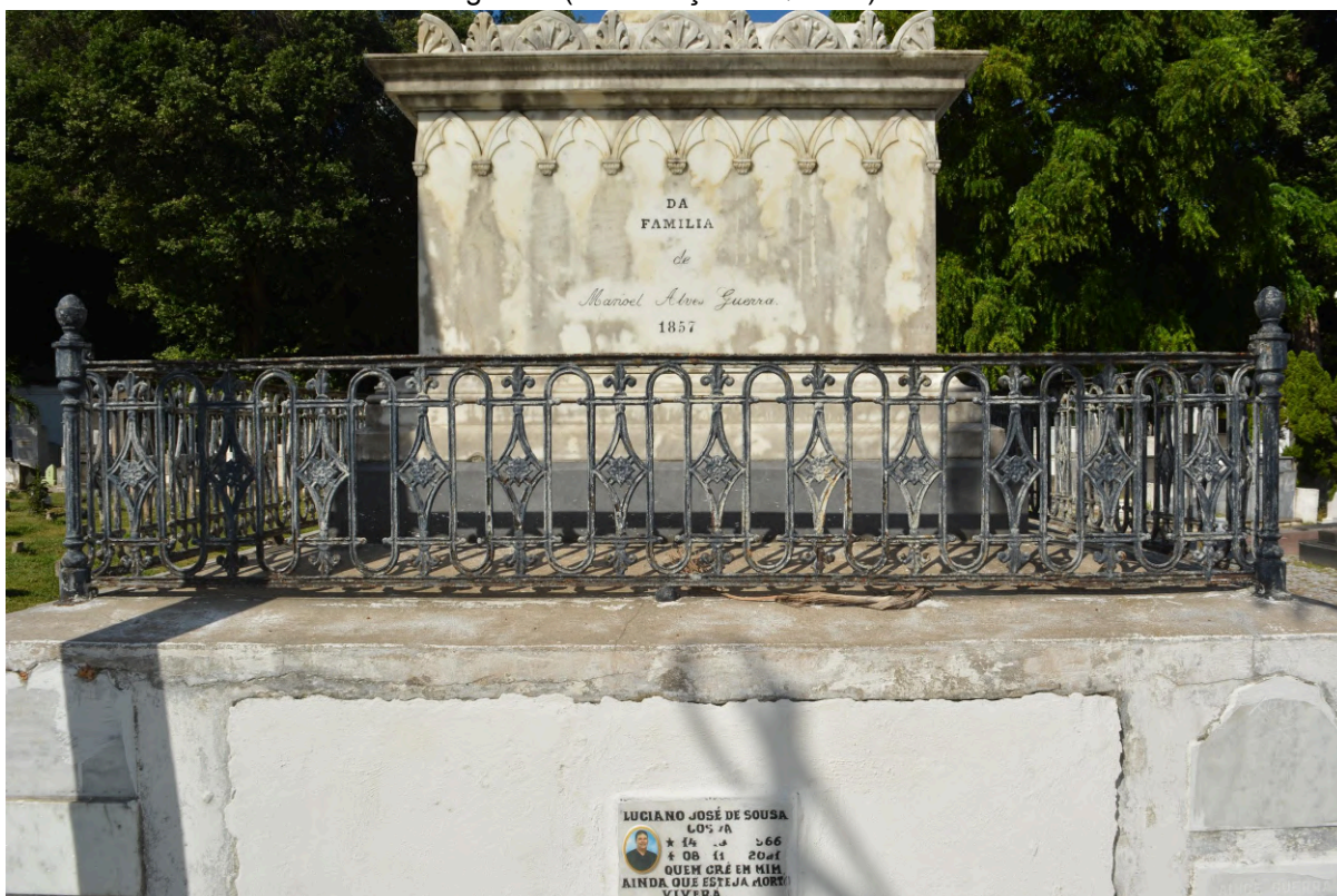
Figura 17 – Gradil Q3 F28, em estado Ruim, com corrosões intermediárias e presença de danos mais graves (Deformação e Quebra).
