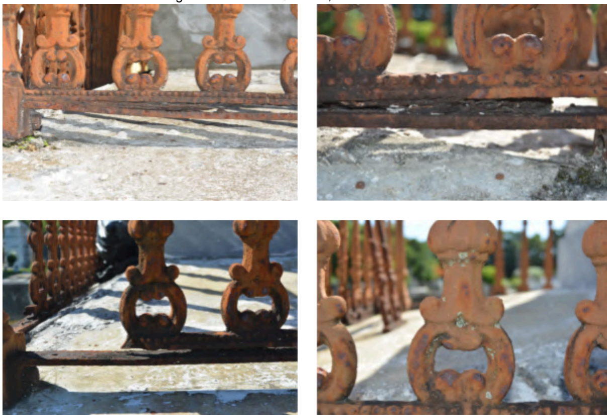
Figura 22 – Gradil Q14 F13, danos em detalhe.
