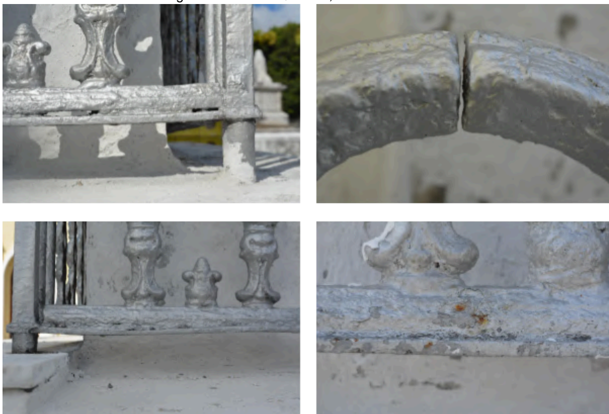
Figura 16 – Gradil Q26 F13, danos em detalhe.
