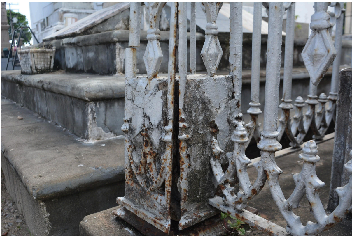
Figura 40 – Exemplo de fenda na junção de módulos, causado pela dilatação do gradil (ferro) e da base (alvenaria).
