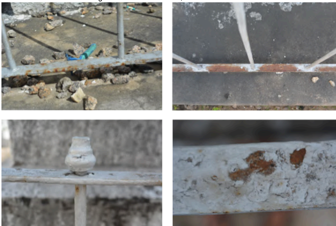
Figura 29 – Gradil R2N8S, danos em detalhe.
