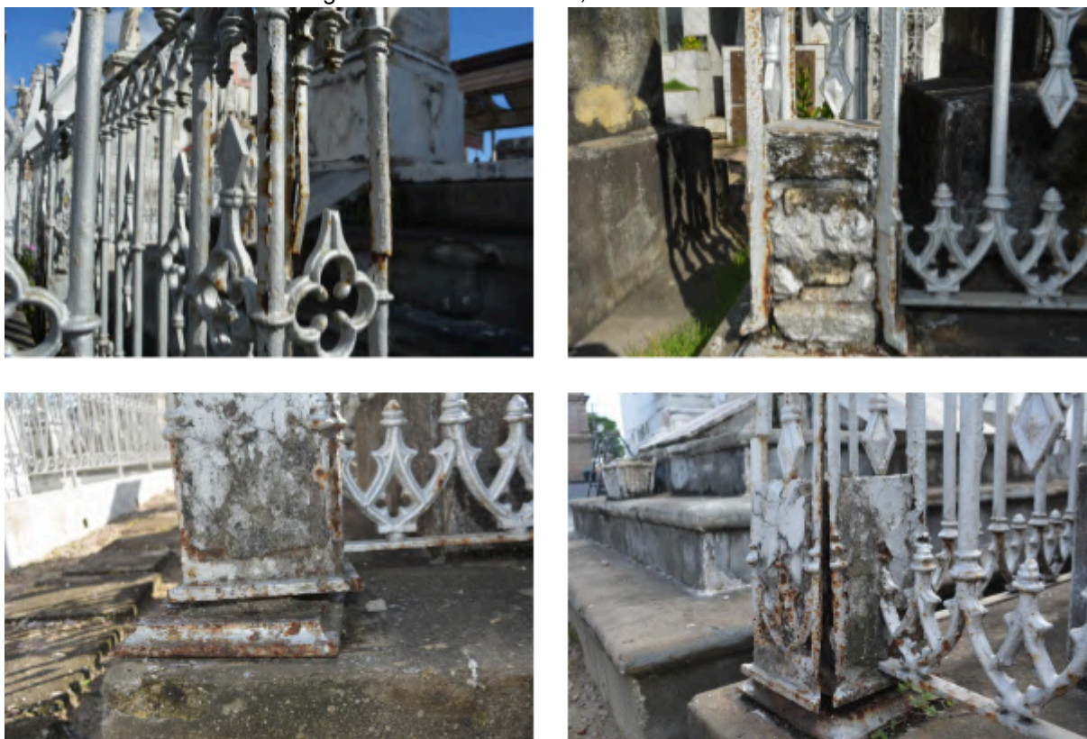
Figura 35 – Gradil R2N4S, danos em detalhe.
