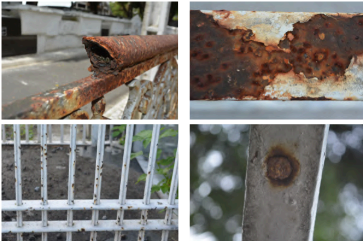
Figuras 6 – Exemplo de formas de corrosão. Gradis do cemitério de Santo Amaro.
