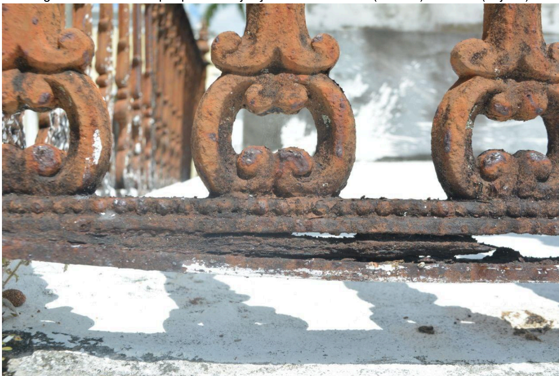
Figura 43 – Corrosão por placas na junção entre o módulo (fundido) e a base (forjada).
