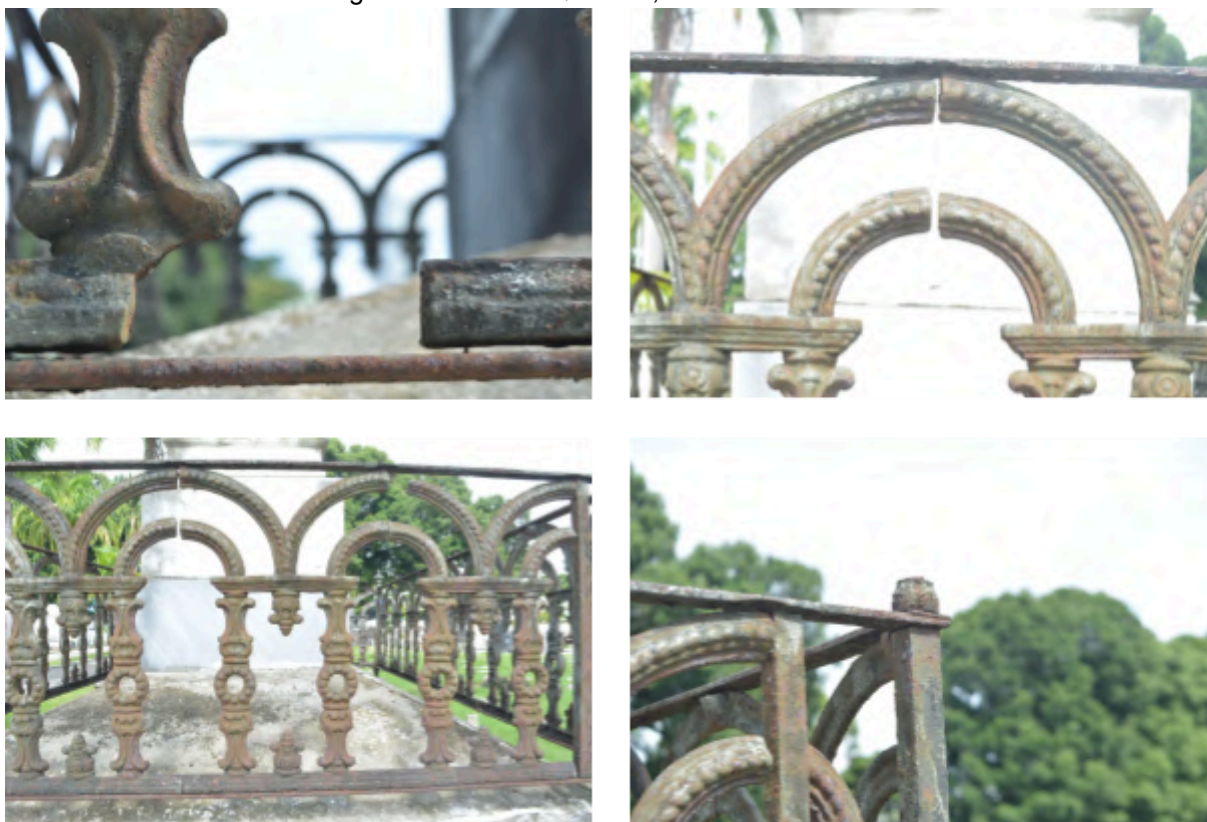
Figura 24 – Gradil Q40 F17, danos em detalhe.
