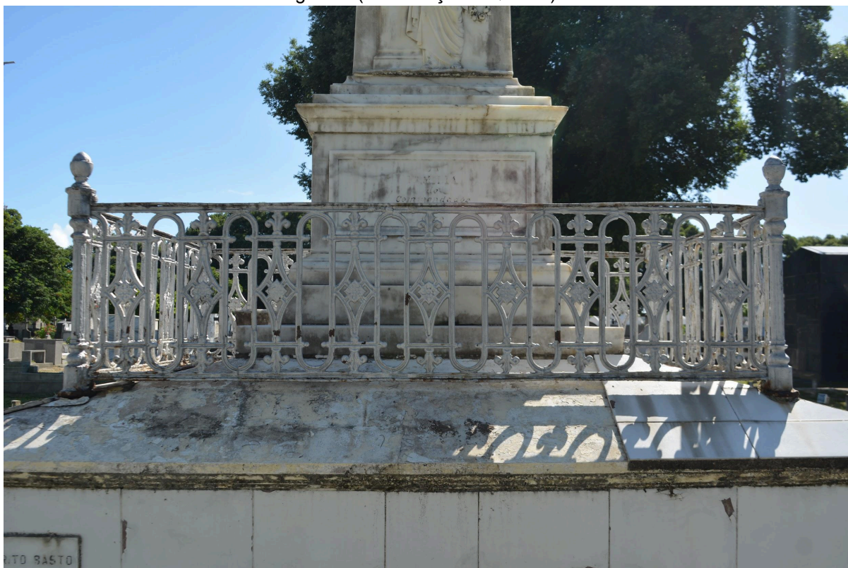
Figura 19 – Gradil Q14 F5, em estado Ruim, com corrosões em estágios intermediários e danos mais graves (Deformação e Quebra).
