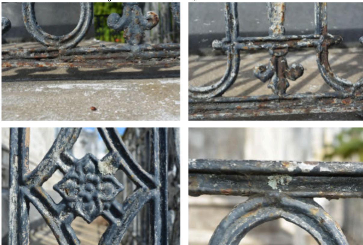
Figura 18 – Gradil Q3 F28, danos em detalhe.
