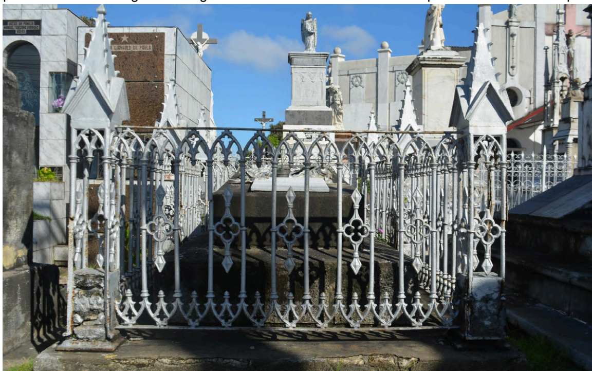
Figura 34 – Gradil R2N4S, em estado Péssimo, com danos e corrosões em estágios avançados e perda intensa da integridade do gradil. Destaca-se o canto inferior esquerdo com Lacuna no pilar.
