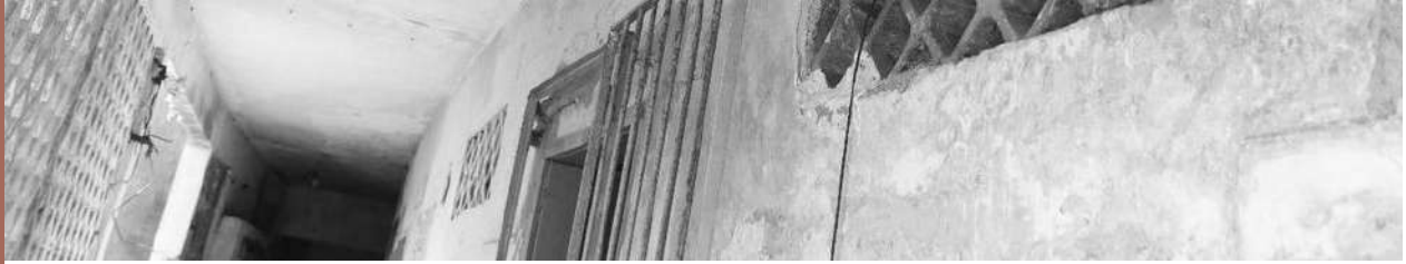
Figura 15: Problemas infraestruturais e fiação exposta. Fonte: Marlon Costa/Pernambuco Press.
