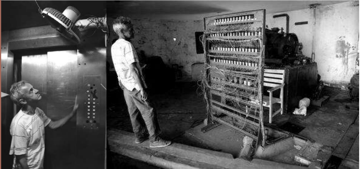
Figura 16 e 17: Do lado esquerdo o estado de conservação do único elevador em funcionamento do edifício e do lado direito a situação precária da casa de máquinas. Fonte: Alexandre Gondim/El País
