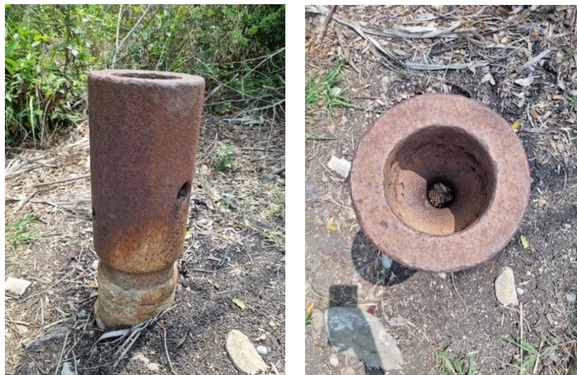
Fotografia 22. Aberturas para respiração de gás natural funcionando na comunidade de San Pedro, San Antonio, SLP.
