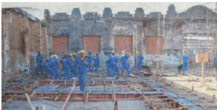
Figuras 218 e 219 – Registro das vedações internas das esquadrias voltada à R. Monsenhor Tapiranga. Fonte: Projeto Cachoeira, Monumenta-EPROM, 2006 in Brendle, 2017.
