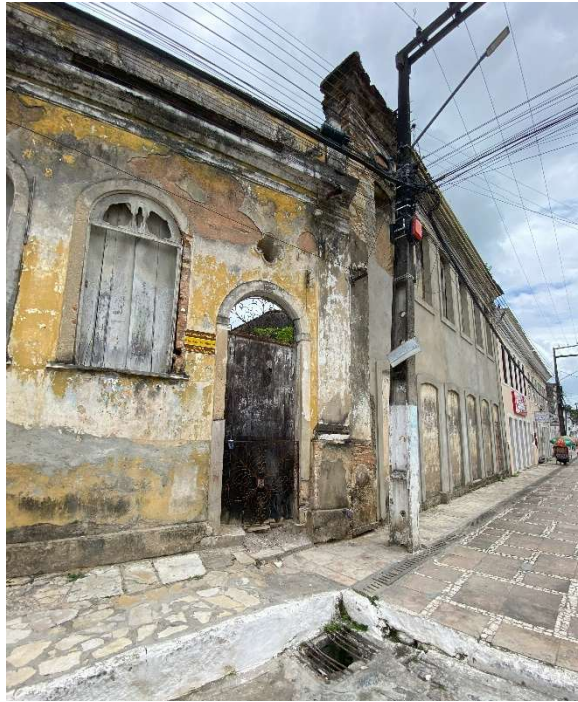
Figura 48 – Outros exemplares de edificações em ruínas, agora no Calçadão Getúlio Vargas. Detalhe para o tratamento na fachada de uma edificação a partir da reconstituição em cimento Fonte: a autora, 2024.
