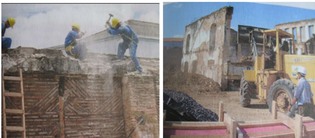
Figuras 239 e 240 – Imagens de destruição de parte da materialidade pré-existente no interior do “quarteirão”. Fonte: Projeto Cachoeira, Monumenta EPROM, 2006 in Brendle (2017).
