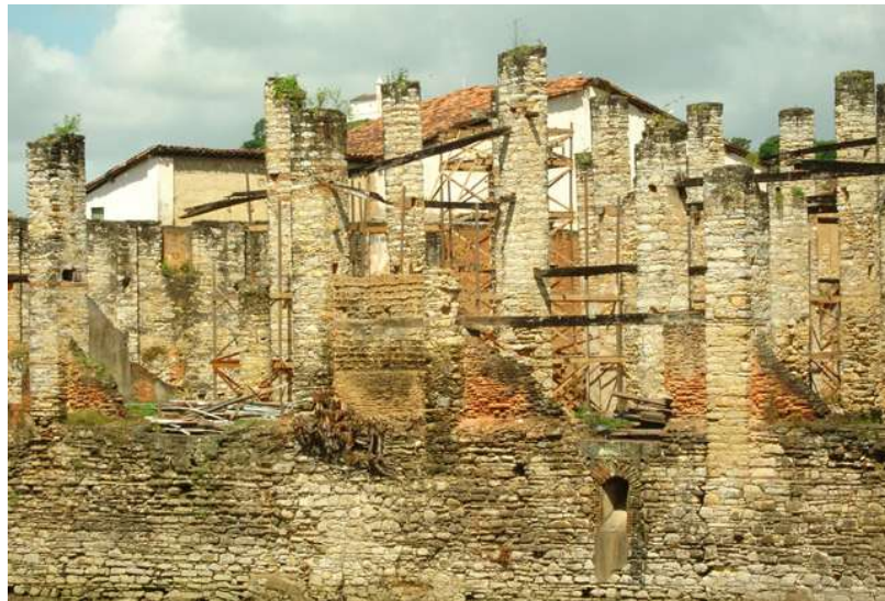
Figuras 62 a 64 – Vistas do Quarteirão dos Trapiches em 2008. Detalhe para a lacuna existente na fachada principal do Trapiche Santo Antônio (acima) e para os pilares de pedra remanescentes (abaixo). Fonte: Marcelo Maciel.
