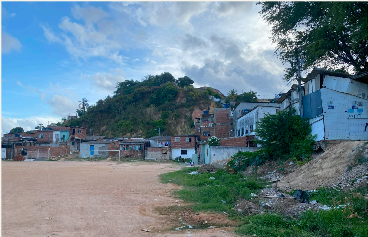
Figura 29 - Encosta em processo de erosão e campo de pelada no seu sopé
