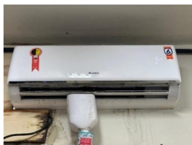
Figura 11 – Ar condicionado - Laboratório de Apoio a Sistemas Computacionais
