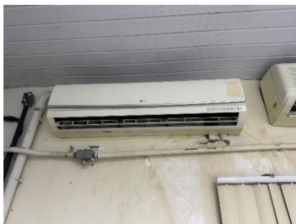
Figura 10 – Ar condicionado - Laboratório de Proteção Radiológica
