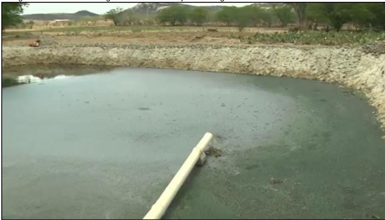
Figura 10 - Entrada das águas residuárias na primeira lagoa através de canos de PVC de 100mm.
