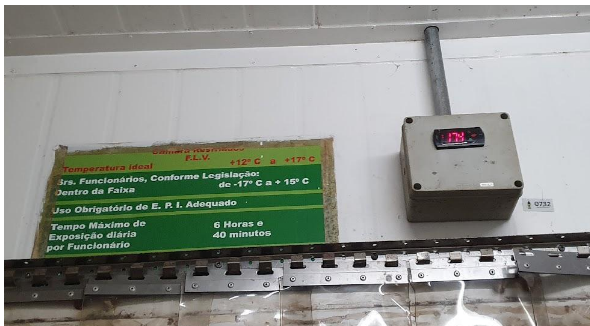
Figura 05 - Painel de temperatura da câmara fria registrando 17,4 °C.
