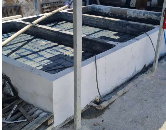
Figura 6 – Leitos de secagem de lodo.
