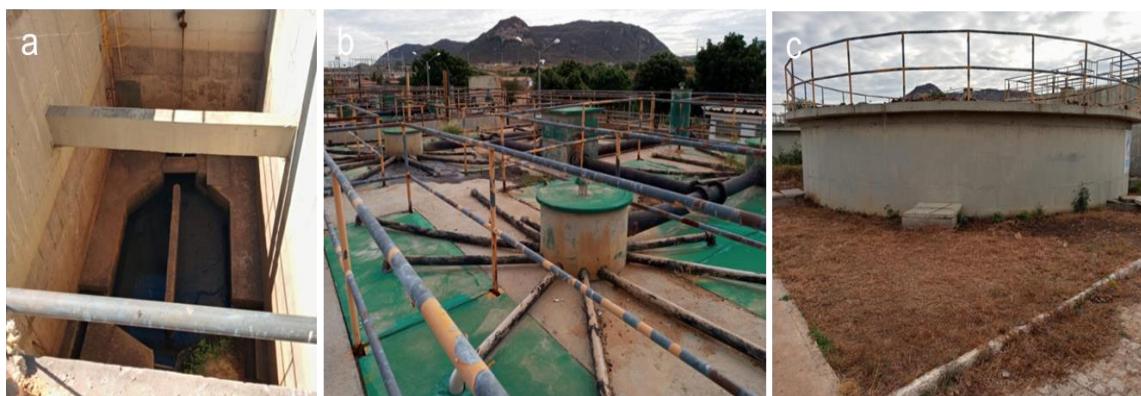
Figura 34 - ETE Salgueiro: a) Desarenador; b) UASB; c) Decantador secundário.
