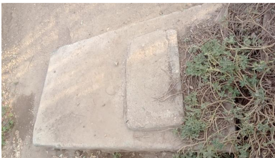
Figura 27 Fossa rudimentar em residência localizada na zona rural de Salgueiro.
