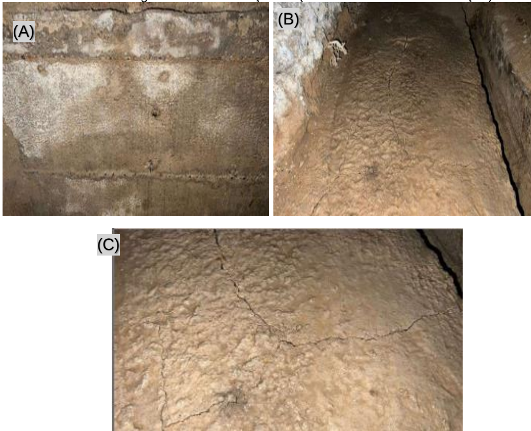
Figura 11- Manifestação 06 (Fissuras no bloco da fundação)
