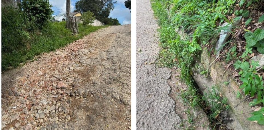
Figura 35: Rua Dr. Freitas Lins com pontos de erosão e canaletas de drenagem.
