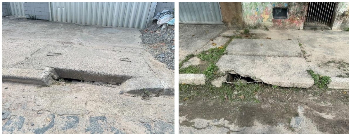
Figura 33: Caixas coletoras obstruídas, com vegetação e danificadas.
