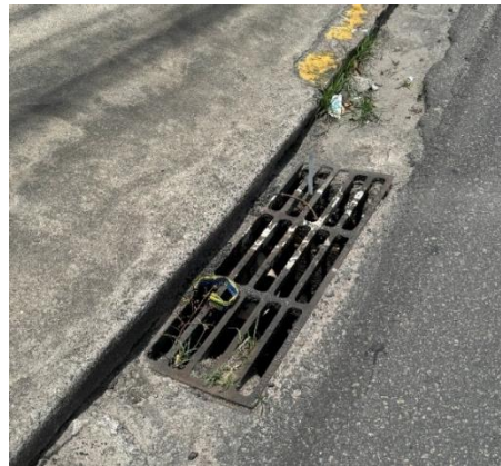
Figura 5: Boca de Lobo com grelha localizada em via urbana.
