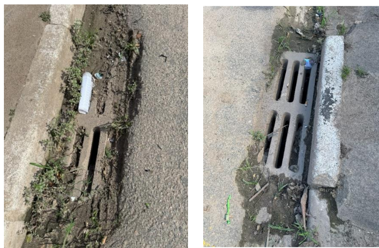
Figura 34: Bocas de Lobo com Grelha.
