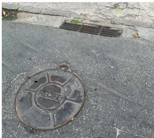
Figura 10: Poço de Visita próximo a uma Boca de Lobo com grelha.
