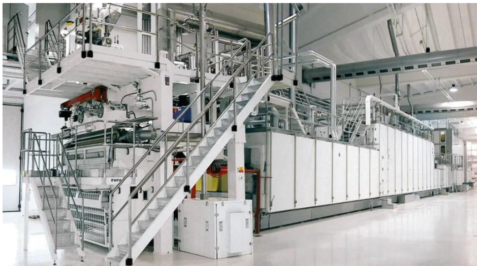
Figura 18 – Túnel de Secagem de massas
