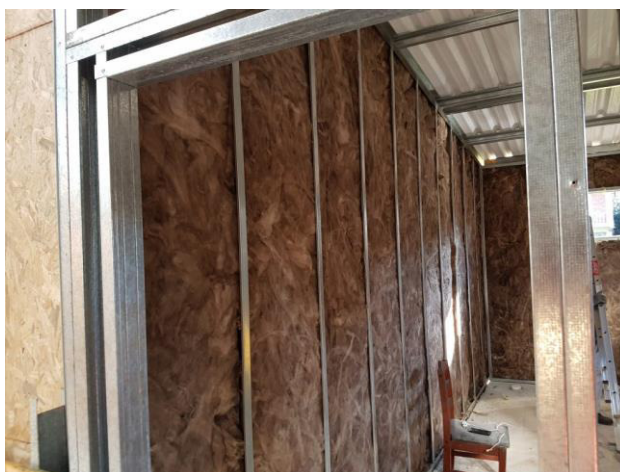
Figura 22 - Isolamento termoacústico em lã mineral.
