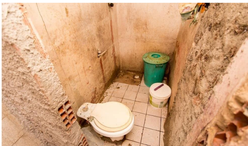
Figura 64 - Banheiro de Dona Lourdes antes da reforma
