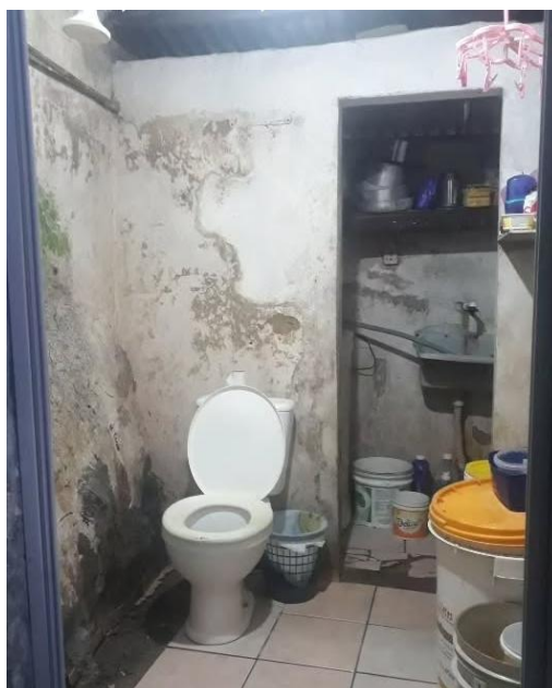
Figura 49 - Banheiro de Virgilina antes da reforma
