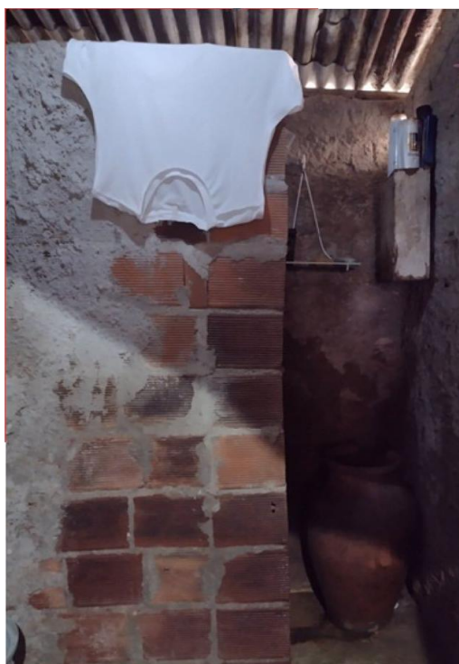
Figura 70 - Banheiro de Dona Nilma antes da reforma
