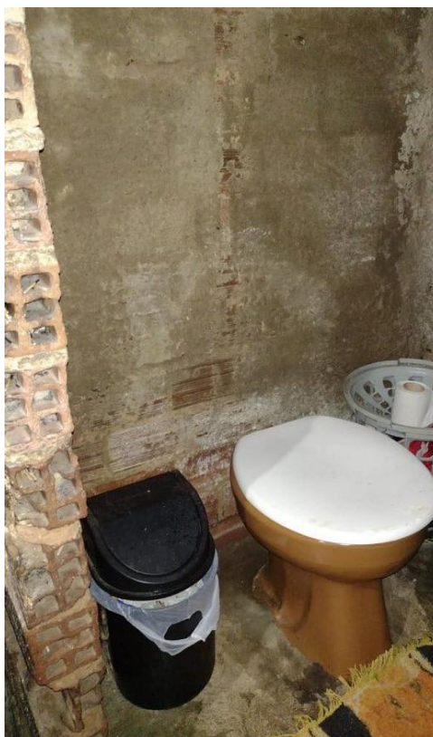
Figura 69 - Banheiro de Dona Nilma antes da reforma
