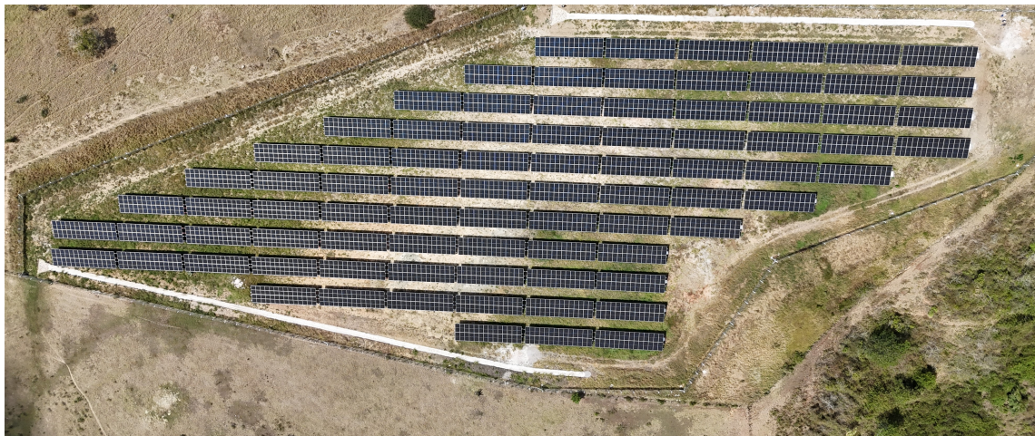
Figura 14 – Usina solar fotovoltaica - UFV Frevo 6 - Pot. Nom. 1.000 kW.
