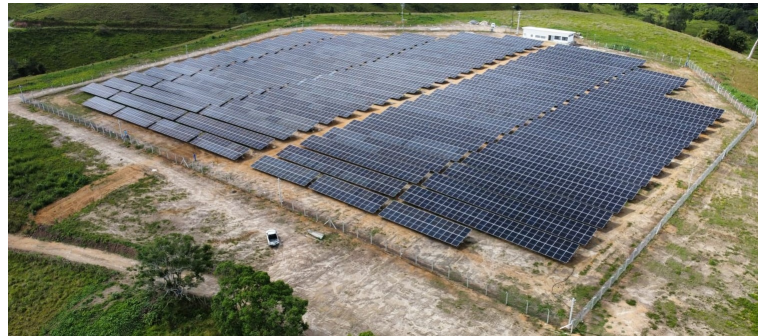
Figura 16 – Usina solar fotovoltaica - UFV Enercred - Pot. Nom. 2.000 kW.
