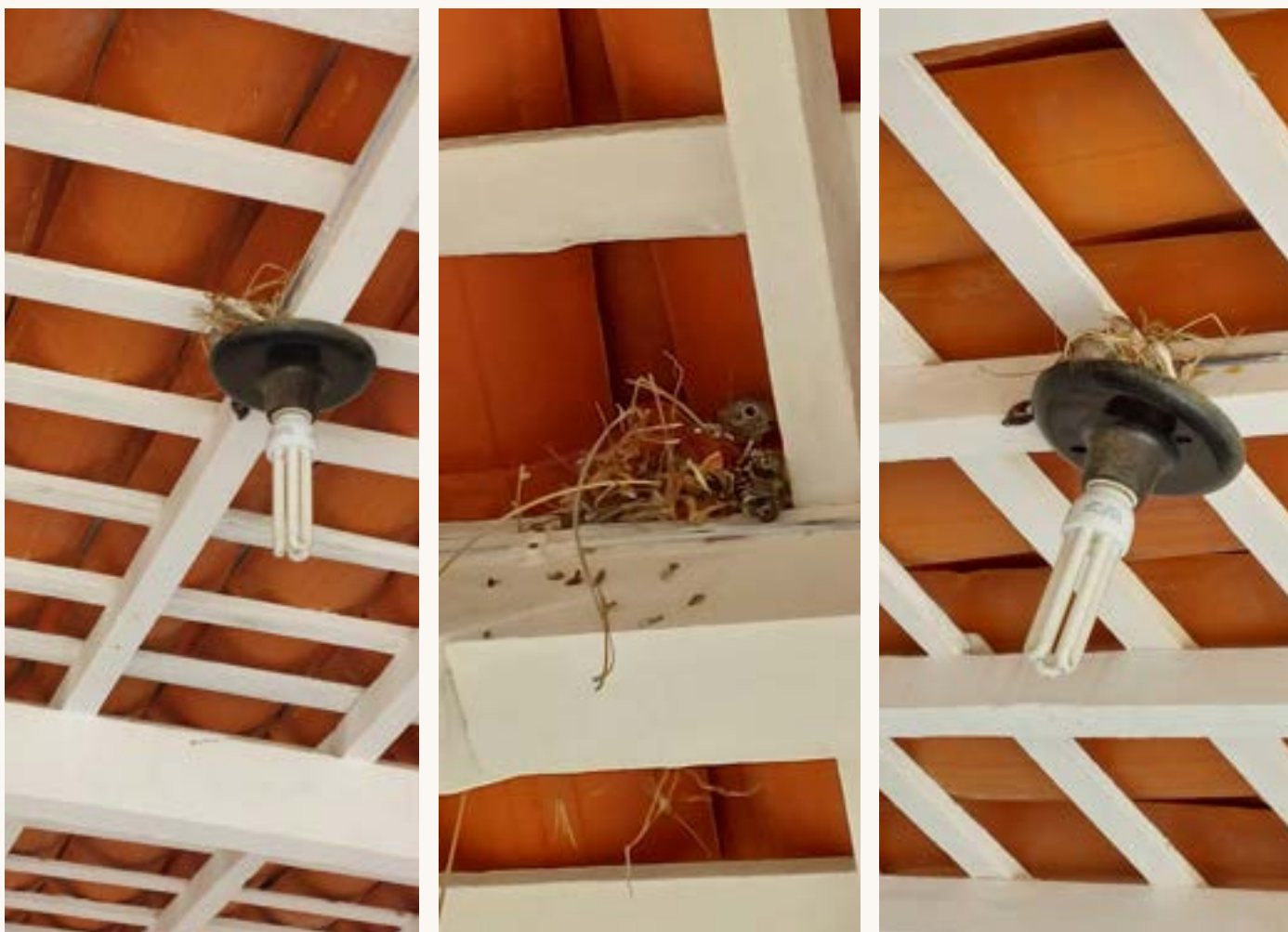
fig II. ninhos de pássaro que se formaram nas telhas da casa de praia onde meu pai cresceu. Uma casa de mais de 40 anos que ainda segue sendo habitada. fonte: a autora.
