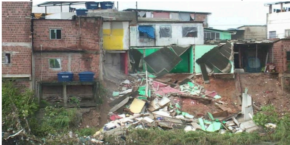
Figura 36 - Casas na comunidade Beira Rio, desabando no Capibaribe.
