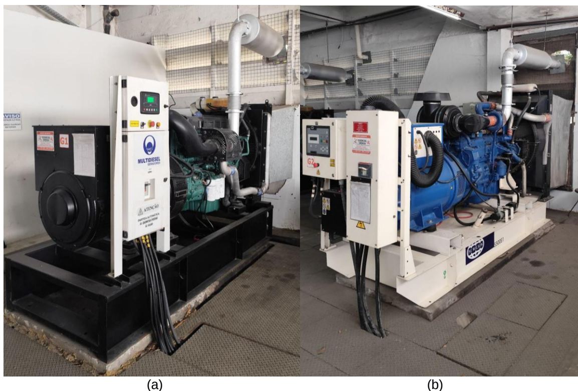
Figura 23 – Geradores a diesel do HC-UFPE: (a) Gerador 1 (G1), (b) Gerador 2 (G2).
