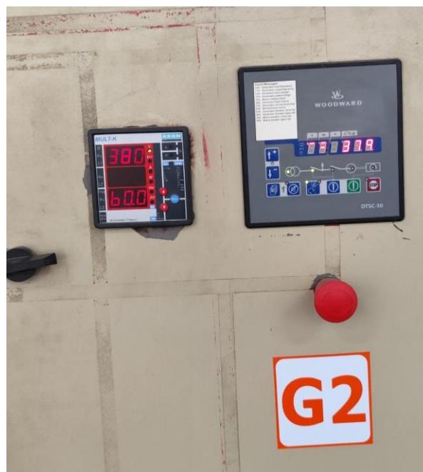
Figura 25 – Painel de comando do gerador G2, acompanhado do módulo de controle.
