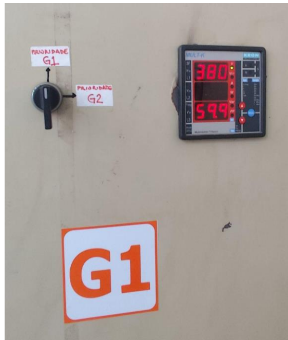
Figura 24 – Painel de comando do gerador G1, acompanhado da chave seletora de prioridade.
