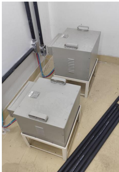
Figura 17 – Transformadores do IT-médico (UTIs).
