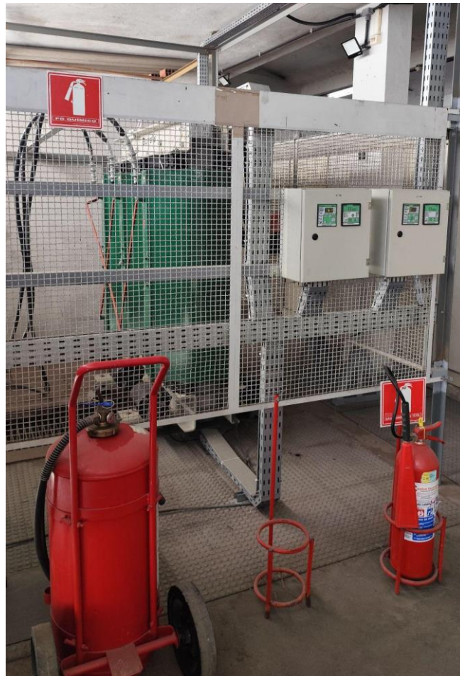
Figura 28 – Recinto de um dos transformadores de potência.
