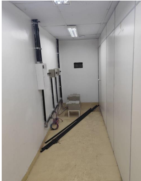
Figura 16 – Local dos transformadores.
