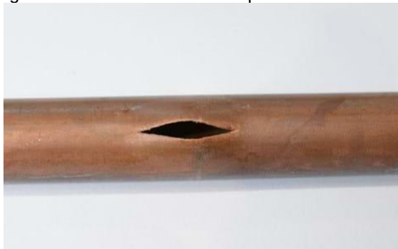
Figura 11 – Trinca em tubo de permutador de calor
