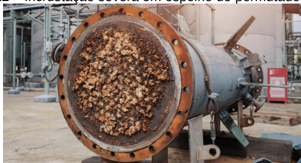
Figura 12 – Incrustação severa em espelho de permutador de calor
