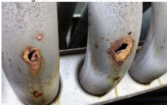
Figura 10 – Erosão de tubos em U
