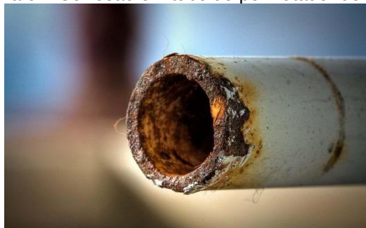
Figura 9 – Corrosão em tubo de permutador de calor
