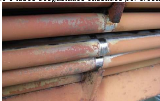
Figura 13 – Defletor quebrado e tubos desgastados causados por erosão radial devido a ressonância
