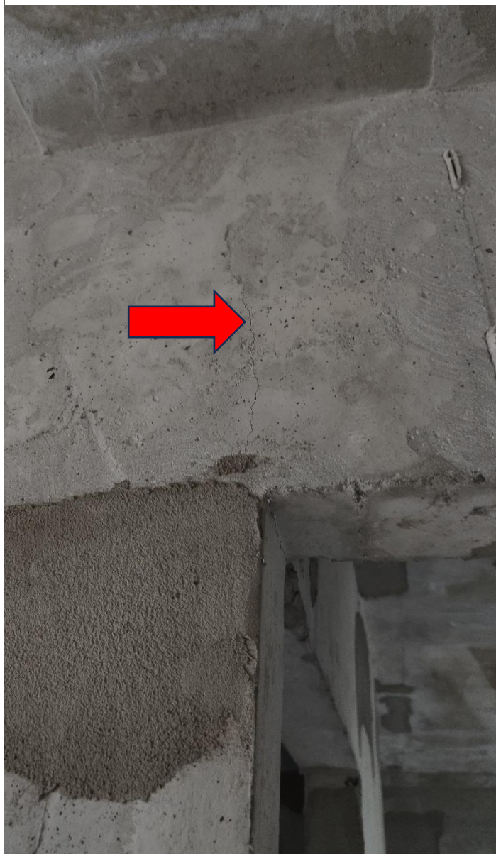
Figura 29 - Fissura na parte superior da porta
