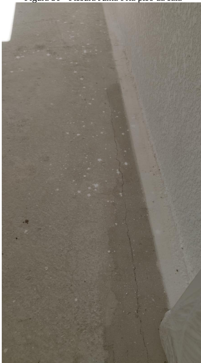
Figura 30 - Fissura Junta Fria piso da sala
