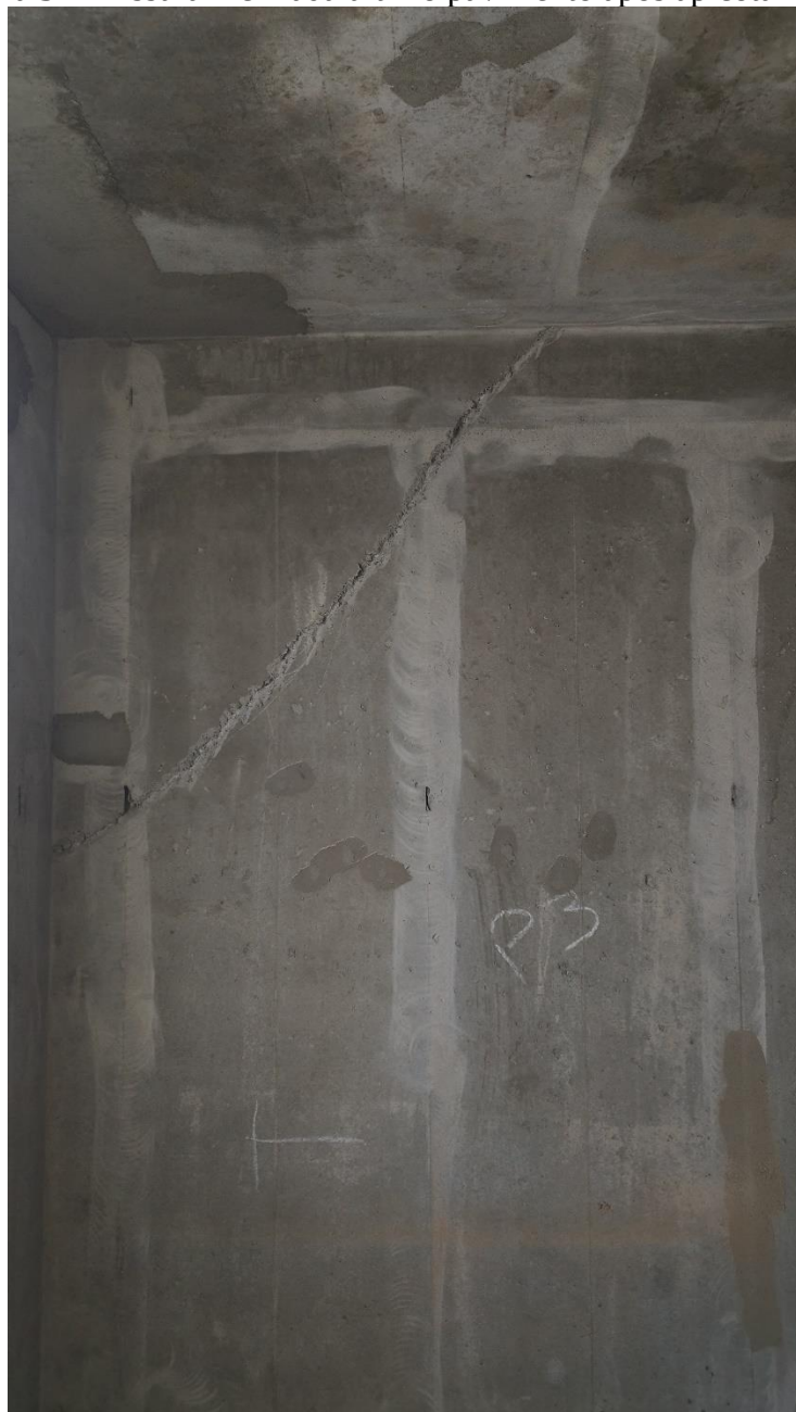
Figura 32 - Fissura inclinada último pavimento após apicotamento.
