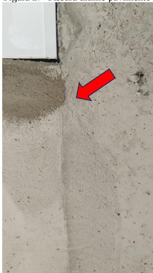
Figura 27- Fissura último pavimento
