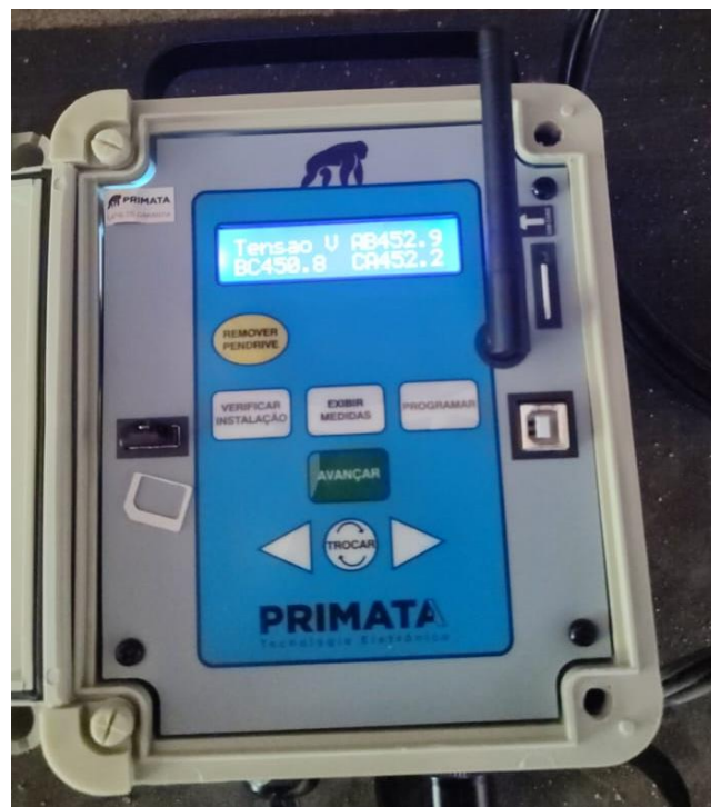
Figura 9 - Grandezas elétricas mostradas no display do medidor
