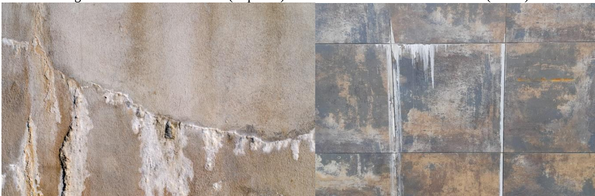
Figura 6: eflorescência reboco (esquerda) eflorescência revestimento cerâmico (direita).
