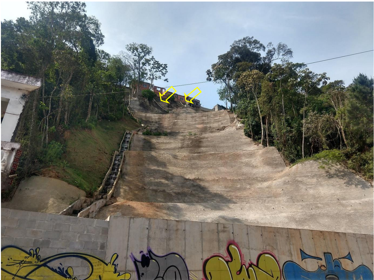
Figura 2 - Obra de contenção realizada em uma cicatriz de escorregamento translacional ocorrido no ano de 2019 na Rua Miguel Fernandes, Bairro Iguatemi – São Paulo/SP. As setas indicam a presença de canos saindo das residências em direção à encosta
