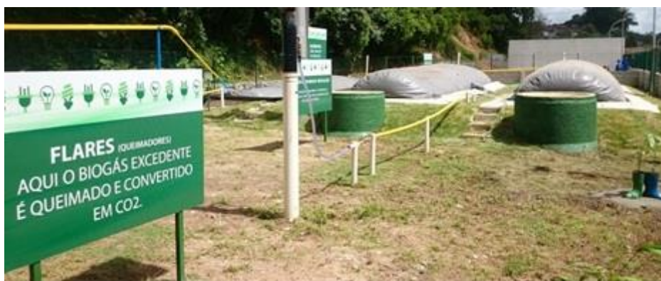
Figura 4. Reatores de Lona (Canadense ou da Marinha) em escala comercial instalado na Reserva Camará na região metropolitana do Recife.
