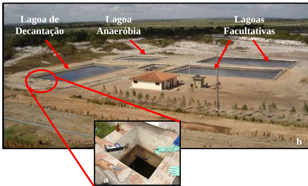
Figura 3.11 - Entrada da Lagoa de Decantação (a); Estação de Tratamento do Chorume (b).
