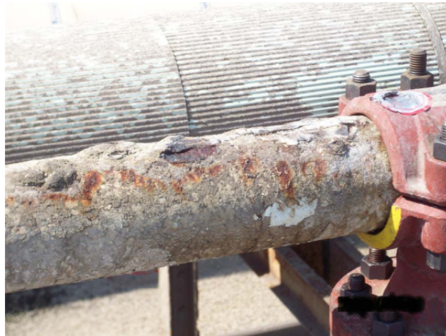
Figura 1 – Corrosão uniforme causada pela atmosfera
