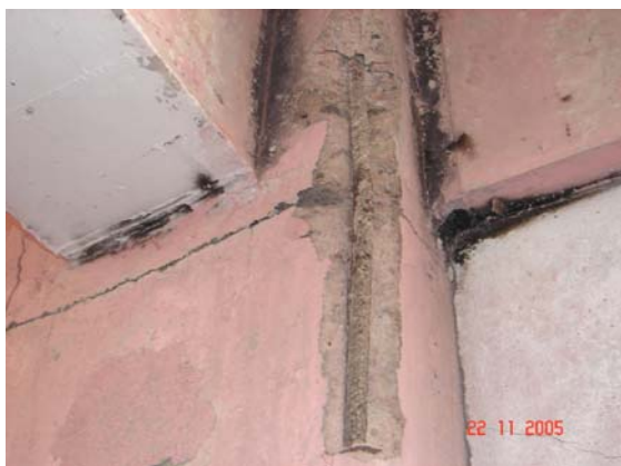
Figura 9 – Lascamento no Pilar P3 (Visão interna).
