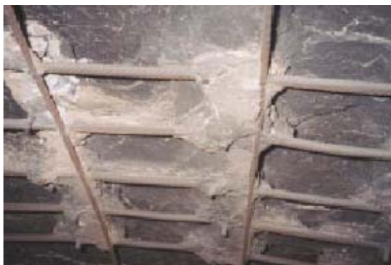
Figura 2.22 – Lascamento explosivo nos anéis do Channel Tunnel – França/Inglaterra (1996). Fonte: Costa et al (2002-b)
