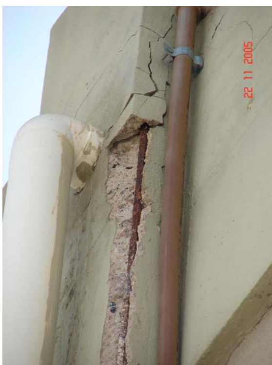
Figura 10 – Lascamento no Pilar P3 (Visão externa)
