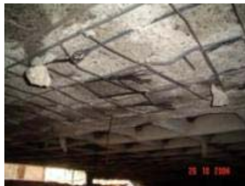
Figura 2.25 – Lascamento da laje de uma edificação – Recife (2004)
