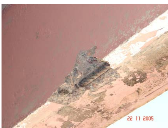
Figura 12 – Lascamento (2) na Viga V101 tramo c
