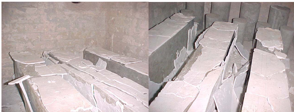
Figura 4.16 Fissuras no revestimento de gesso
