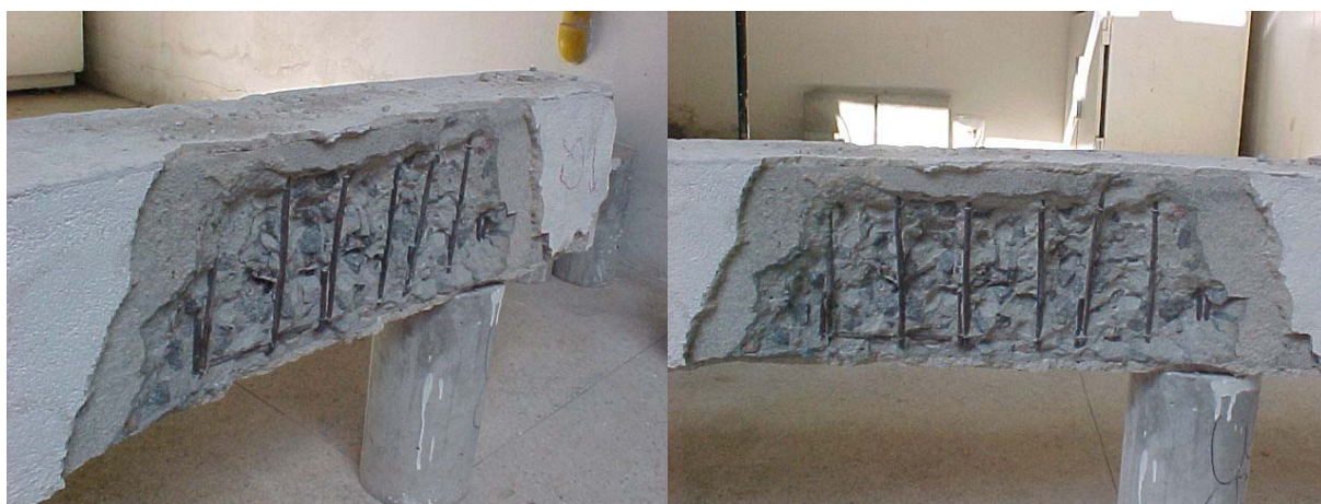
Figura 4.18 Lascamento(i.e. spalling) na viga C07 do experimento RECverm_60min
