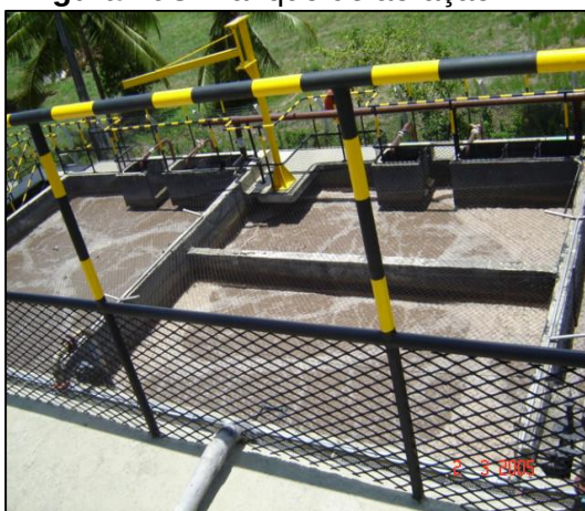
Figura 10C: Tanque de aeração
