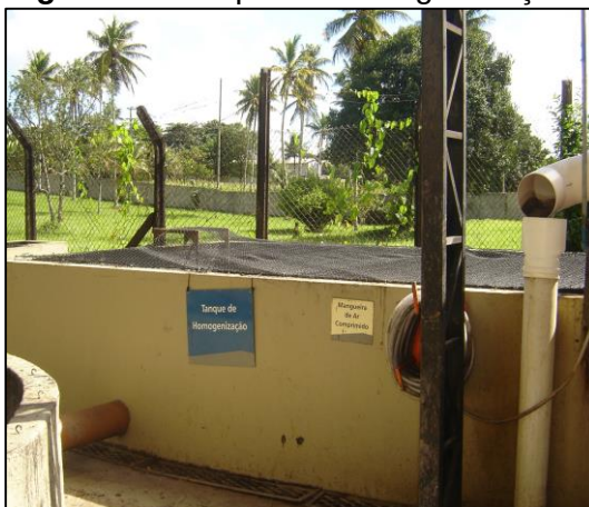
Figura 4C: Tanque de homogeneização
