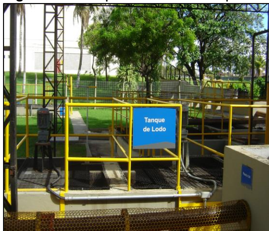
Figura 7C: Tanque de lodo físico-químico
