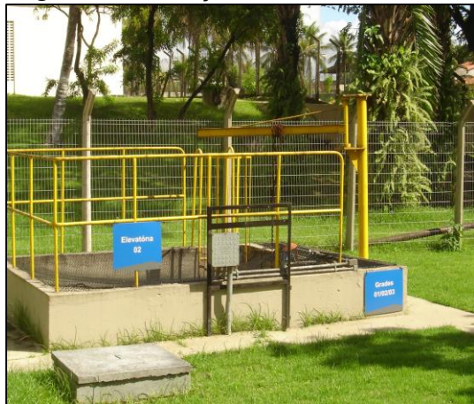
Figura 1C: Estação elevatória II
