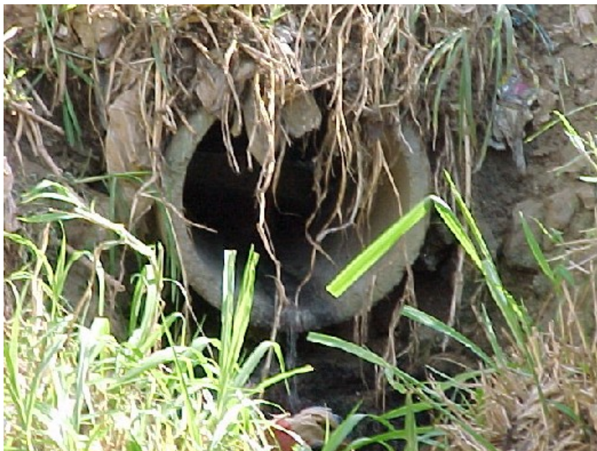
Foto 9 - Lançamento de esgoto “in natura” no Rio Jaboatão.
