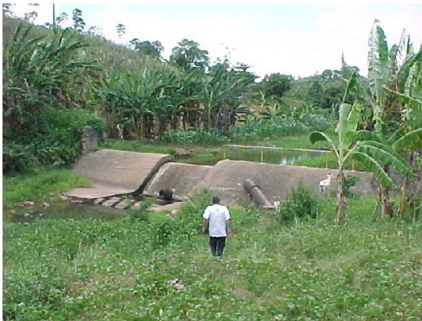
Foto 6 – Ponto de captação da barragem da COMPESA.
