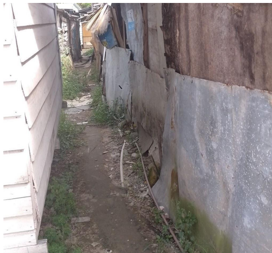
Figura 18- Estado de conservação de madeiras do barracos
