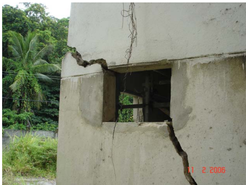
Figura 3.3 – Rachadura no bloco E
