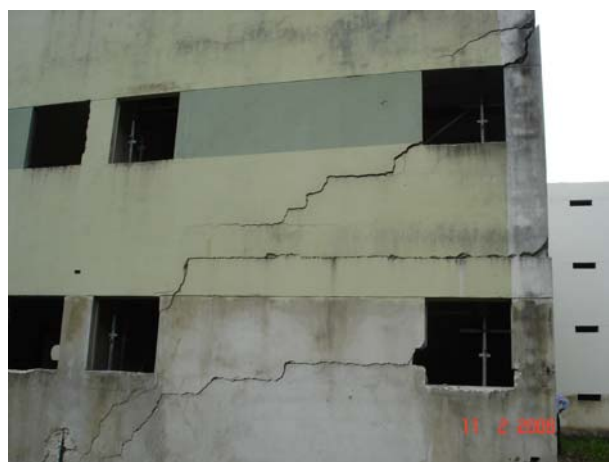
Figura 5.4 – Bloco E – grandes rachaduras
