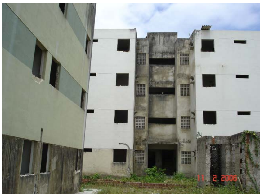
Figura 3.2 – Desaprumo do bloco D.
