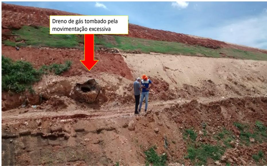
Figura 15 - Imagem com tombamento de parte do dreno vertical
