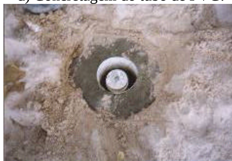
f) Anel de concreto.
