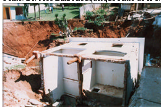
Figura 2.11: Colapso em Cajamar, em São Paulo, no ano de 1986.
