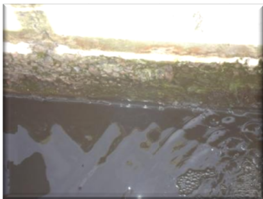
(a) Ataque do concreto no canal de coleta dos efluentes dos reatores UASB.
