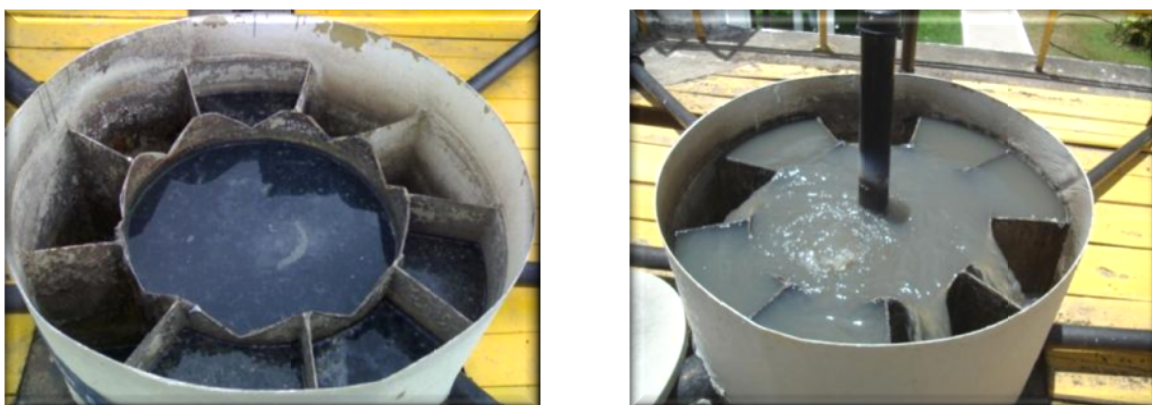
Figura 5.2: Obstruções nas tubulações de entrada do reator UASB.
