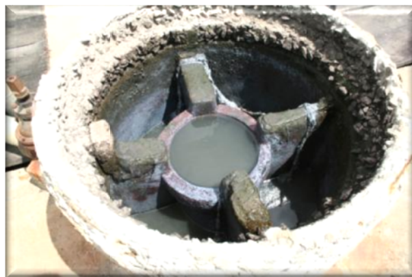
(b) Ataque do concreto na caixa de distribuição de vazão
