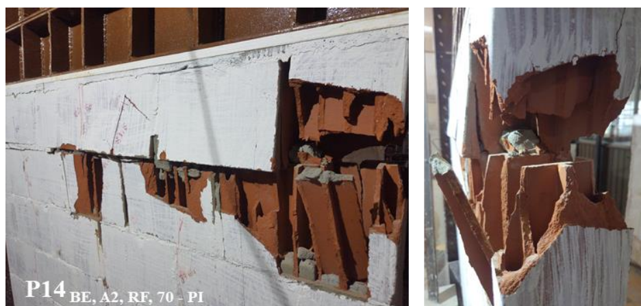
Foto 33 – Detalhe do modo de falha da parede P14
