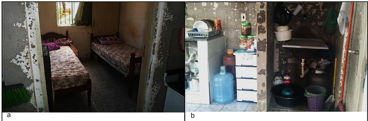
Figura 36: Quarto do cadeirante (a), com adaptações da entrada do vão e divisão entre pia e tanque (b)
