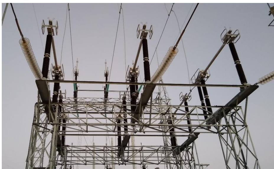
Fotografia 5 - Chave seccionadora Fonte: Própria (2022)
