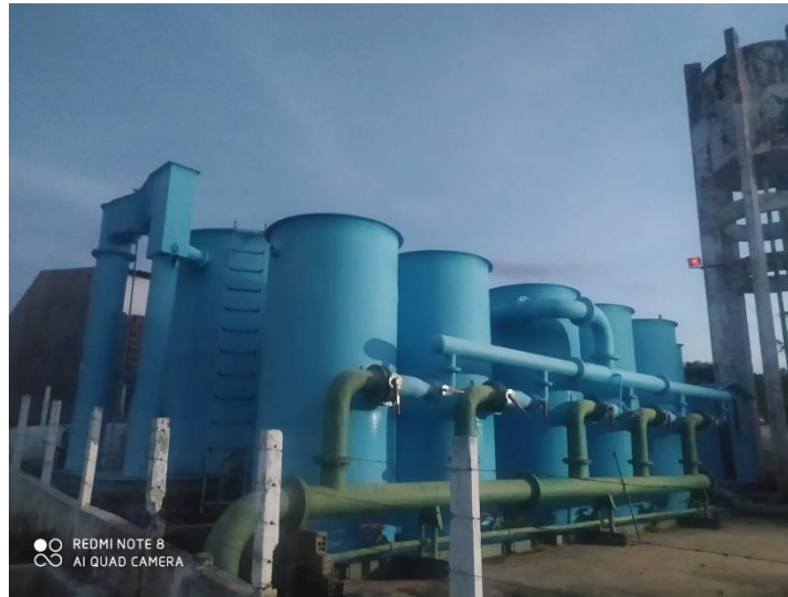
Figura 22 Estação de Tratamento de Água.
