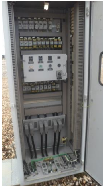
Figura 20 - Visão Geral do Armário Central de um Disjuntor de Alta tensão
