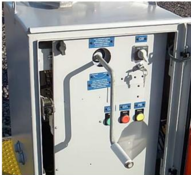
Figura 23 - Acionamento Manual de uma Chave Seccionadora de Alta Tensão
