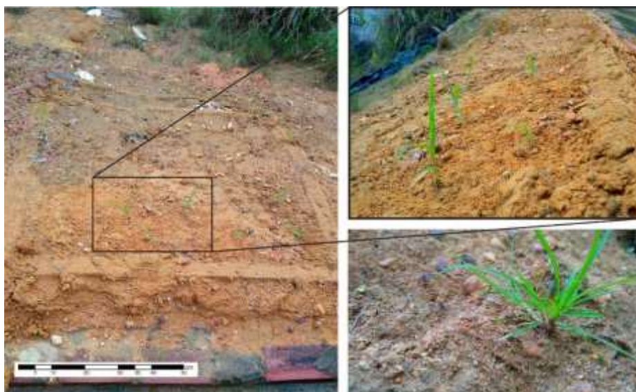
Figura 56: Crescimento de vegetação existente após retirada da placa de proteção.
